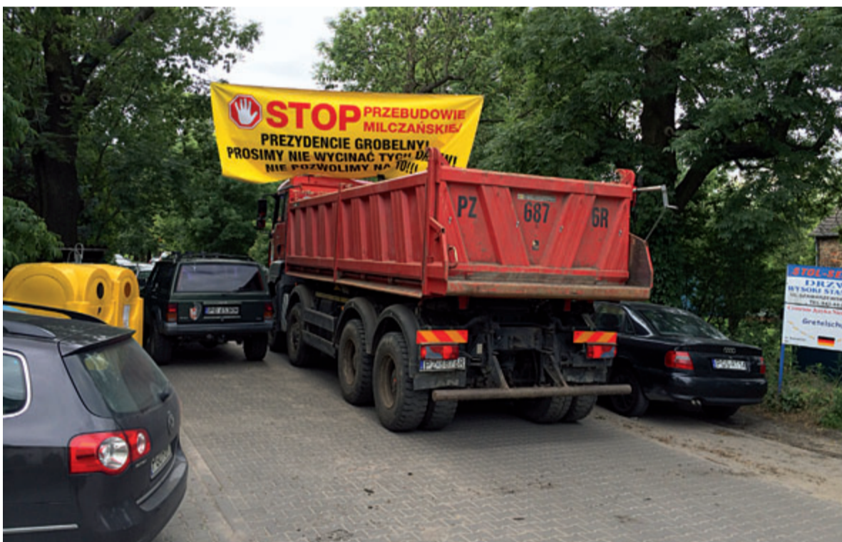
Zdj. Transport ziemi przy budowie CH Łacina prowadzony ul. Milczańską pod banerem protestacyjnym.
