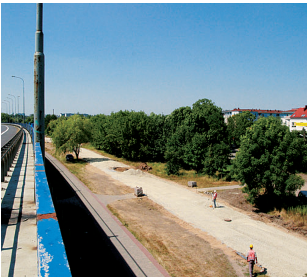
Zdj. Od lewej północna strona estakady katowickiej pozbawiona wg planu ekranu dźwiękochłonnego, obok budowana droga robocza do obsługi inwestycji – w tym miejscu mieszkańcy proponują poprowadzenie drogi zbiorczej do galerii handlowej, po prawej zabudowania mieszkalne narażone na hałas z estakady.
